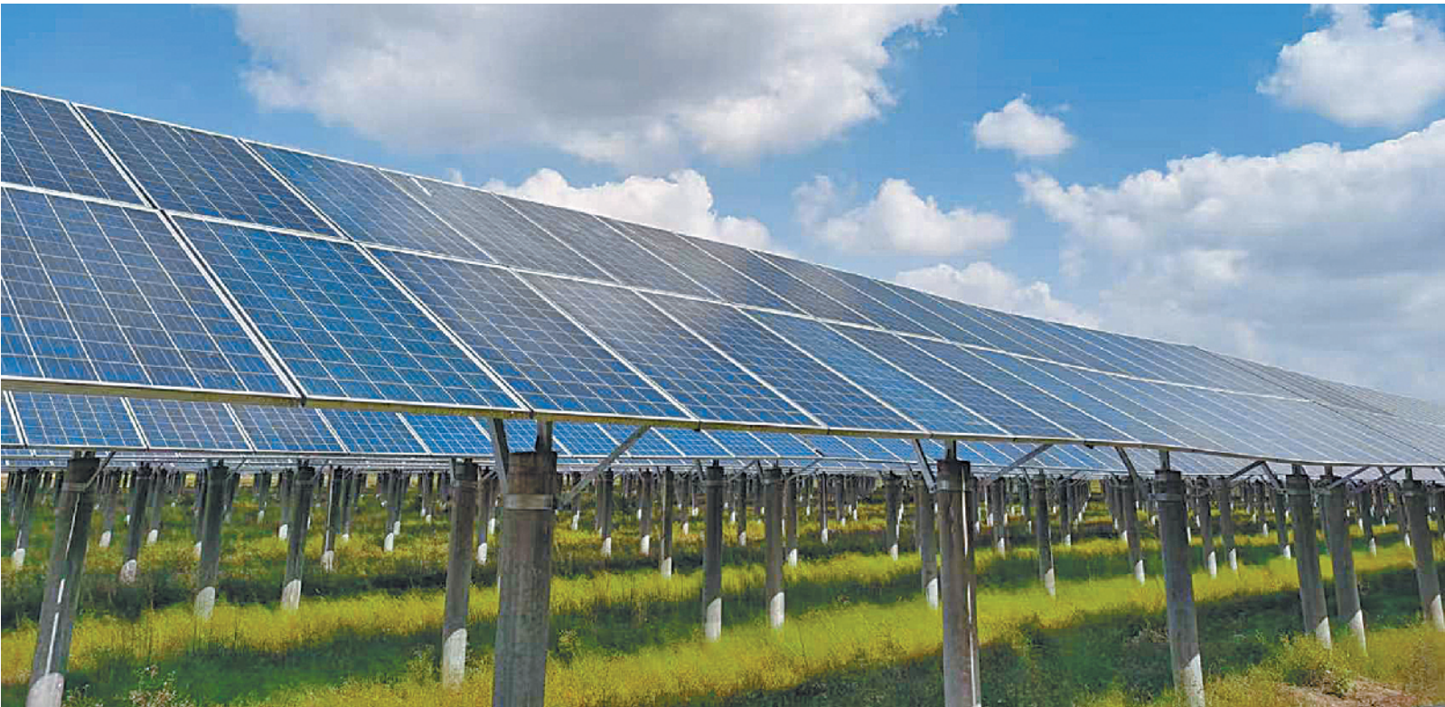
徐州国投集团光伏电站。 受访单位 供图
