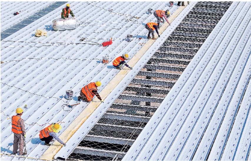
江苏兰坤控股集团新型装饰材料生产项目建设现场。徐报“五一”报道组 摄
