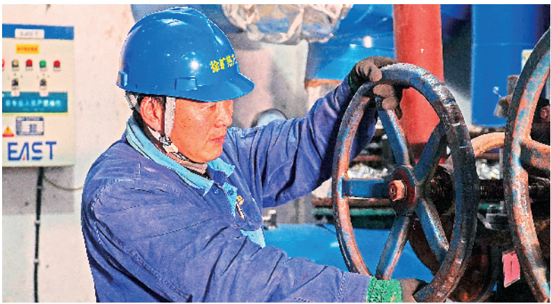
换热站内，工作人员在检查设备。 本报记者 陈炯全 摄
