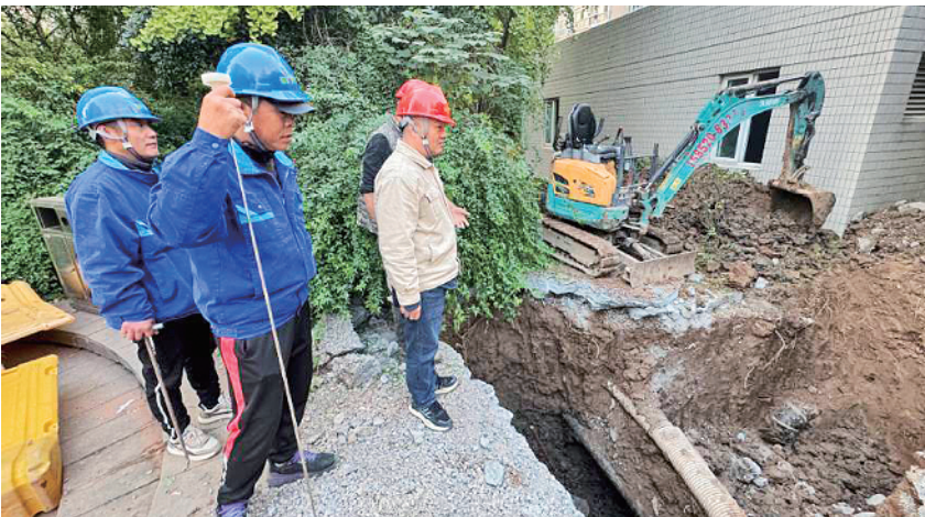
工作人员现场勘查受损供热管线。 本报记者 张静 摄
