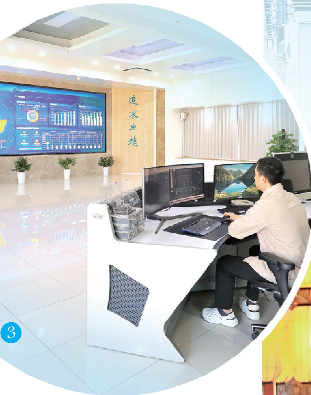
图③ 调控中心地区调度班密切跟踪负荷情况，时刻做好应急处置准备
