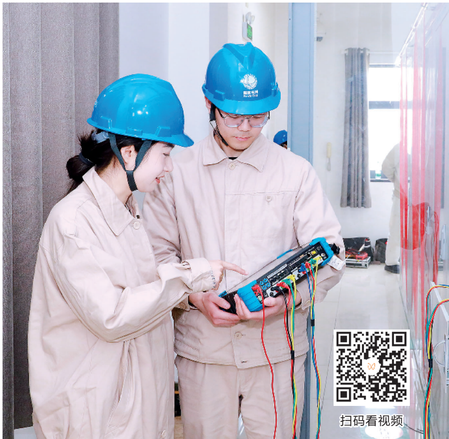
国网徐州供电公司员工为记者讲解继保仪设备。
